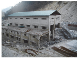
被災した川沿いの水力発電所
