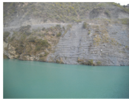
森林局施工の土止め工（一部崩れている）
